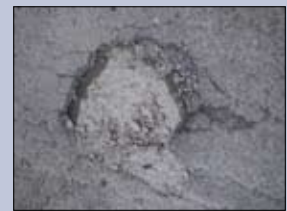
Daño inducido por la humedad
